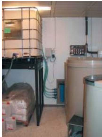
Produktionsanlagen mit Filtration und Verteilung für Konzentrate in Verbindung mit hochgestellten Lagertanks zur Schwerkraftversorgung zentraler Leitungen
